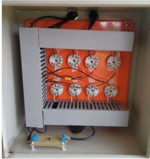
Figura 37: Vista interna do quadro com oito transmissores de temperatura.
