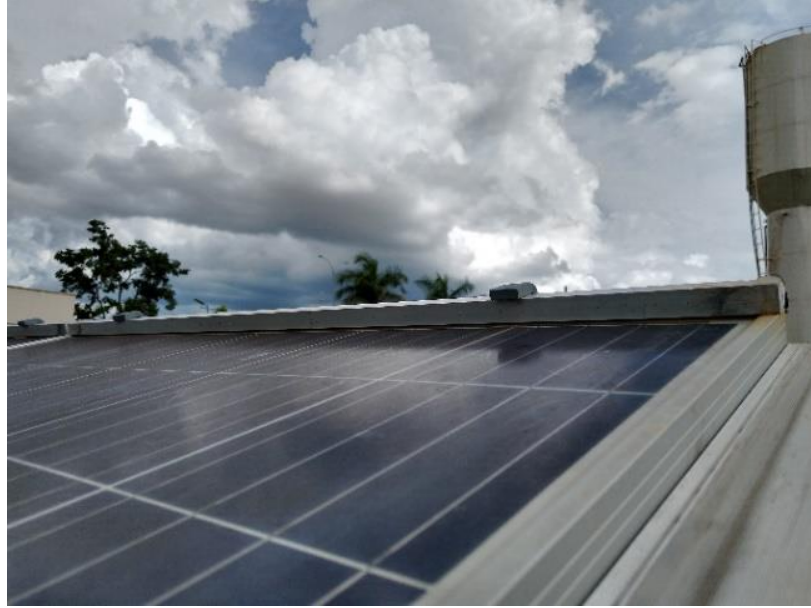
Figura 30: Perfis de alumínio na borda dos painéis.
