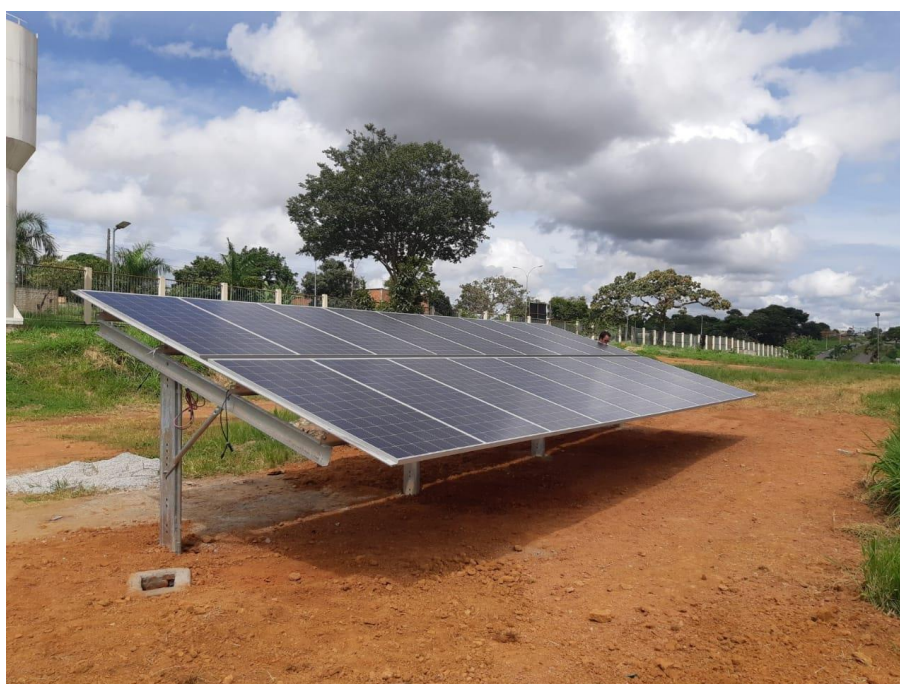
Figura 18: Estrutura de fixação dos painéis no solo com duas strings de 9 painéis cada.
