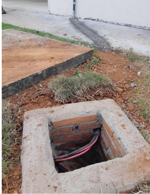
Figura 19: Caixa de passagem com cabos elétricos do sistema fotovoltaico instalado.
