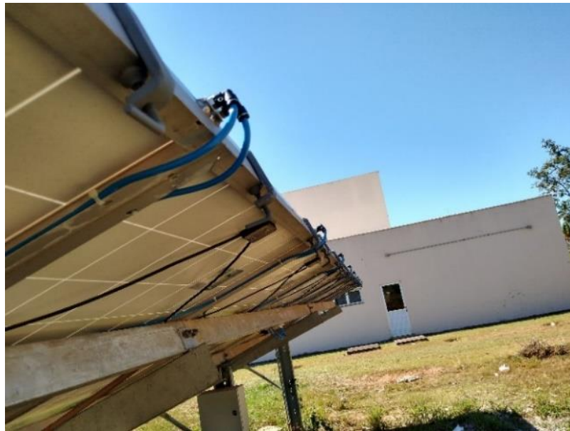
Figura 29: Detalhes da tubulação com mangueiras de poliuretano.
