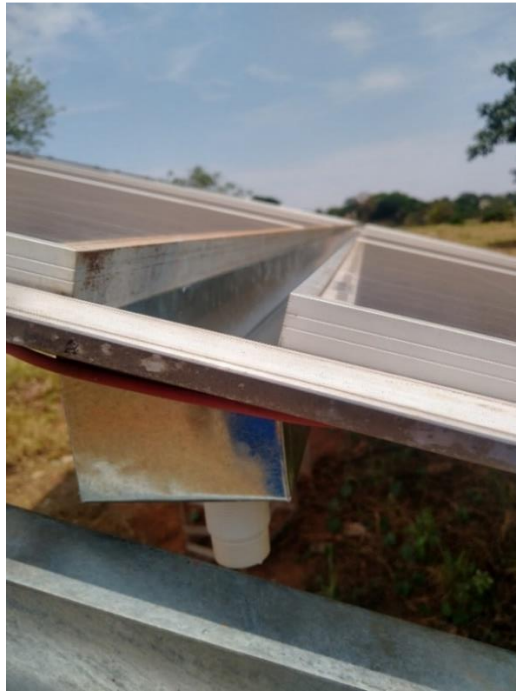
Figura 32: Calha de coleta da água após arrefecimento dos painéis.
