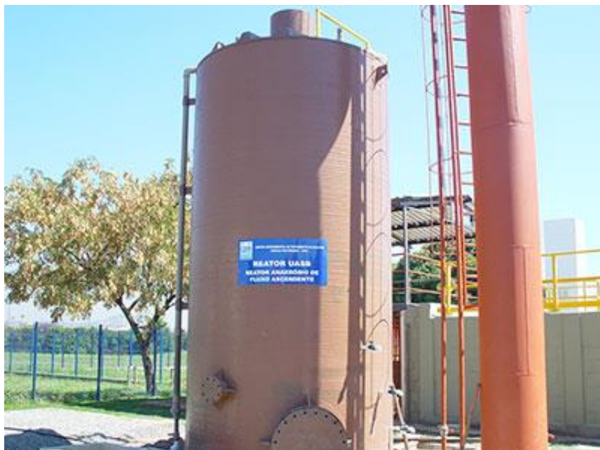
Figura 10: Reator UASB do CETE Poli/UFRJ. Fonte: CESA, 2021.
