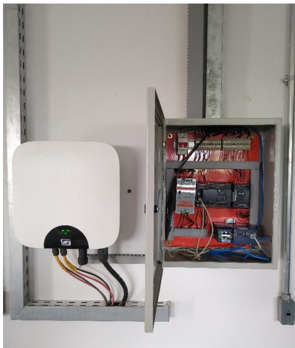
Figura 39: Quadro com dispositivos instalado ao lado do inversor solar.
