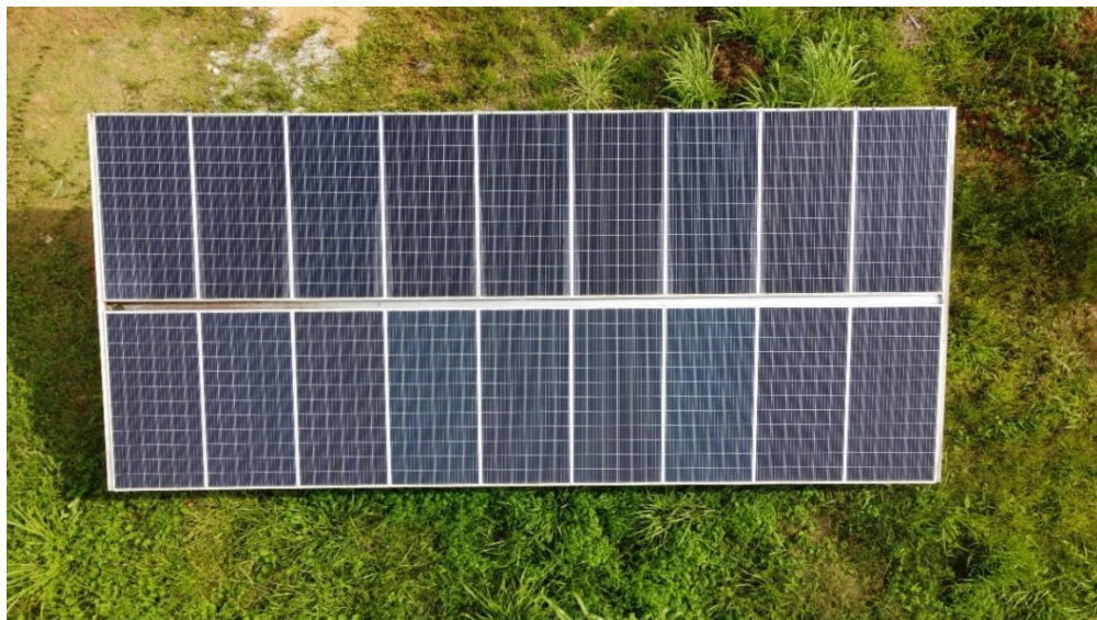
Figura 31: Vista aérea dos painéis no solo.
