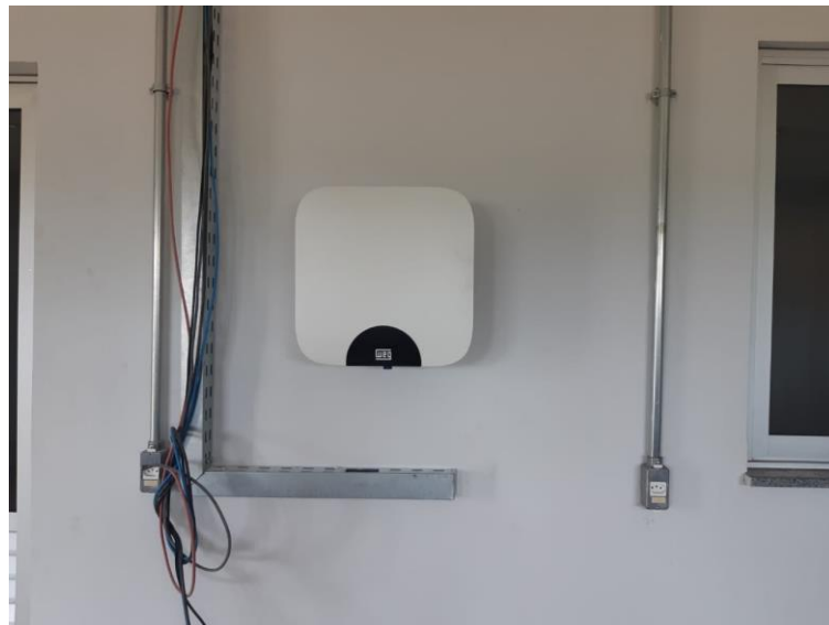
Figura 20: Inversor String SIW300H M050 WEG da usina solo.
