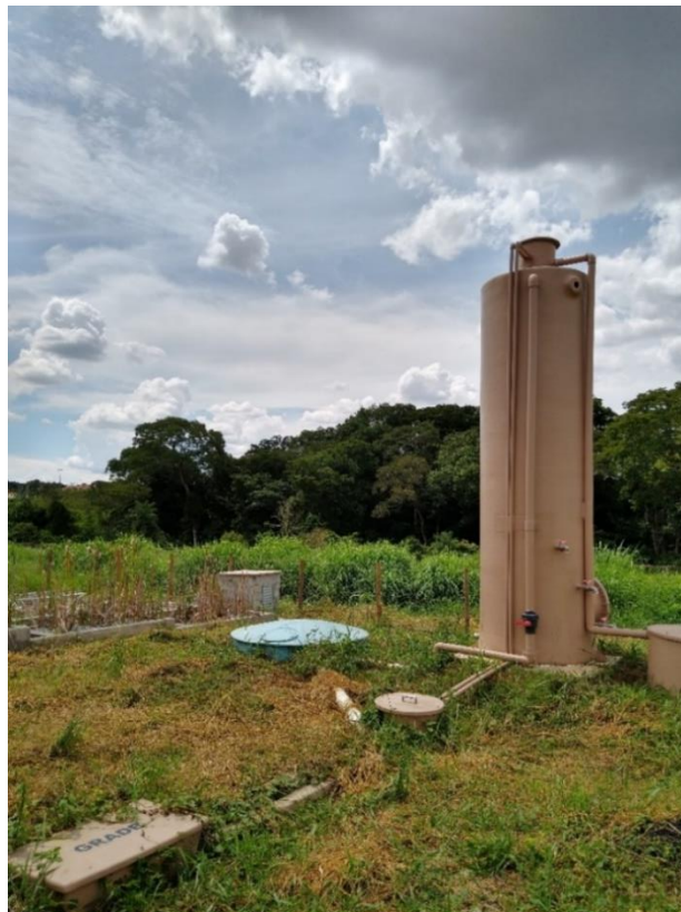
Figura 22: Sistema de tratamento de esgoto do Campus Aparecida de Goiânia, composto por reator UASB e Wetland .
