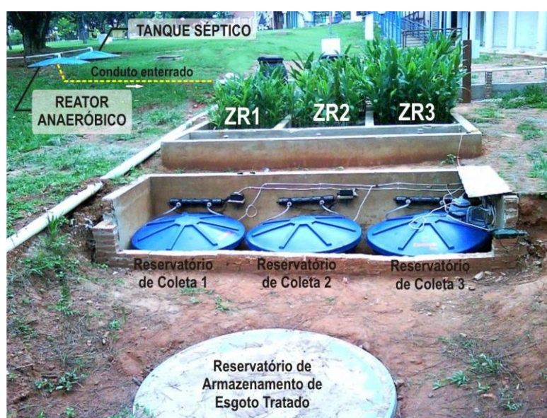
Figura 11: Sistema Wetland construído na EECA da UFG. Fonte: EECA, 2021.
